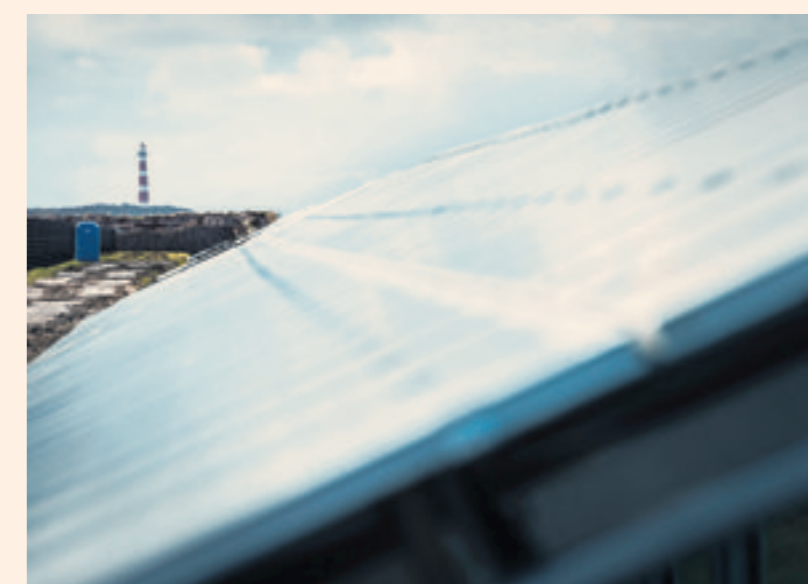
De zonnepanelen moeten 3500 inwoners van stroom voorzien.
